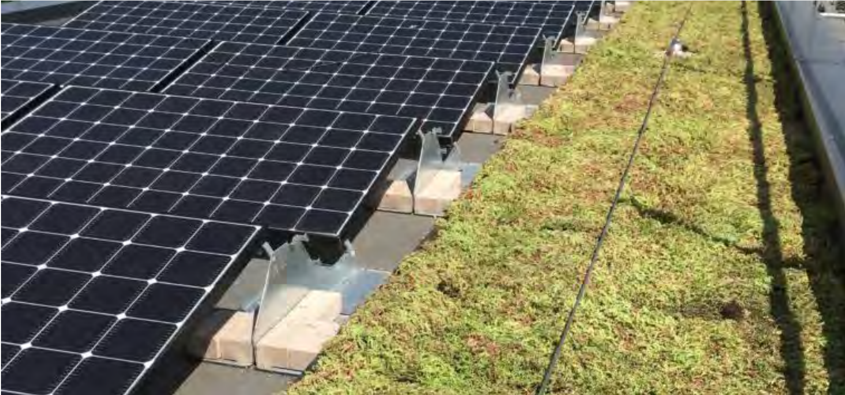
Biosolar rooftop exemplar
